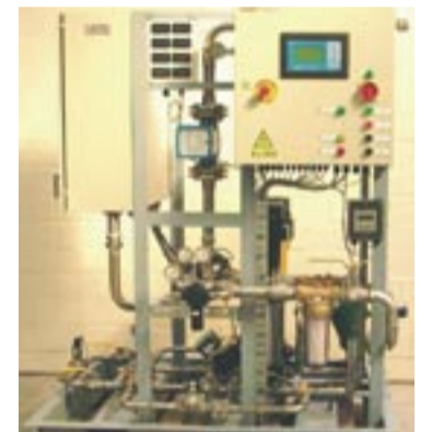
Kaasunjäähdytyksen täydellinen ohjauksjärjestelmä.
